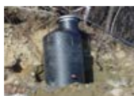
Chambres eau potable
