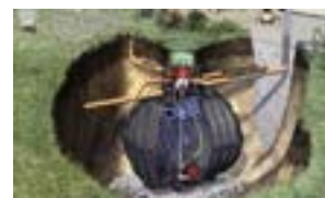
Cuves eaux pluviales
